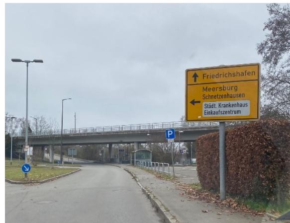
Der Die Brücke in Manzell ist dringend sanierungsbedürftig.
